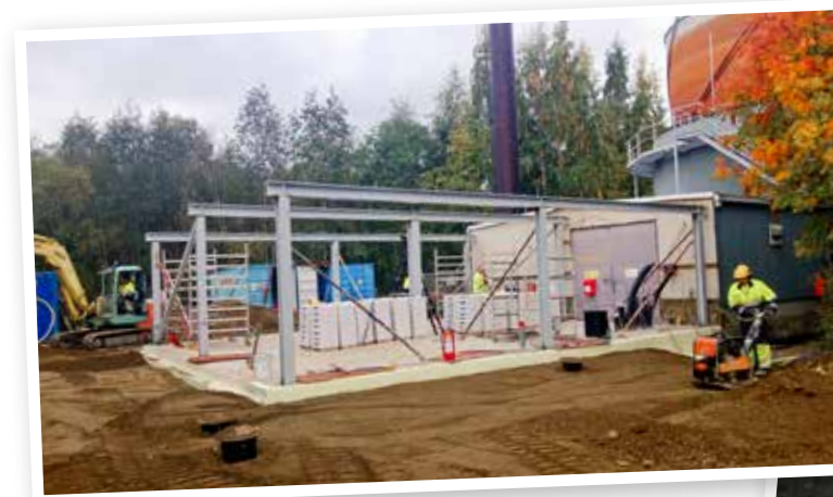
Kuhasalon lämpöpumppulaitos ja ilmanvaihdon lämmöntalteenotto
